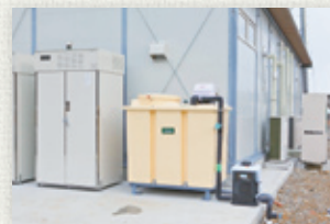
水道が復旧していないため店外に貯水タンクを設置しています。
