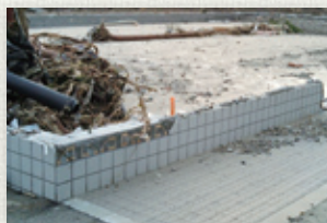
津波で店舗が流され、残ったのは土台だけでした。
