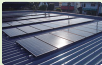
太陽光パネル
