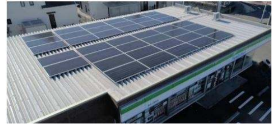
太陽光パネル
