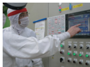
炊飯室のコントロールパネルで火力や工程を確認
